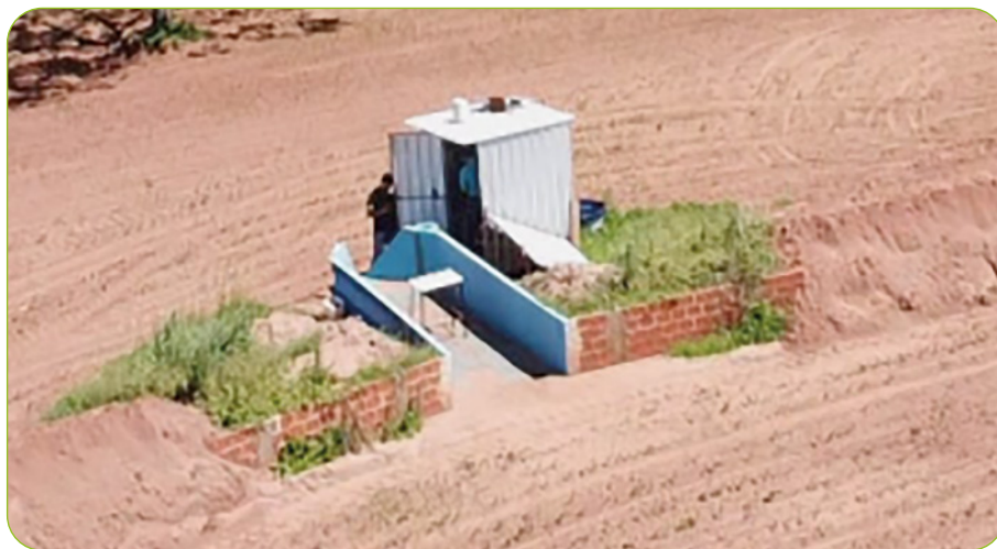
Figura 6 – Calha H instalada em uma megaparcela na bacia hidrográfica de Cianorte-PR
