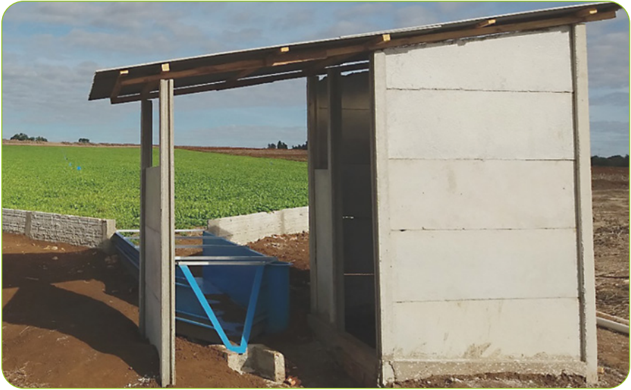
Figura 2 – Calha H instalada em uma megaparcela na bacia hidrográfica de Guaruapuava-PR
