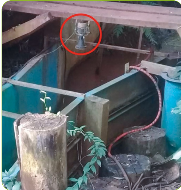
Figura 13 – Sensor de radar para medida do nível do rio, instalado junto à calha Parshall da seção de monitoramento da bacia hidrográfica de Cambé-PR
