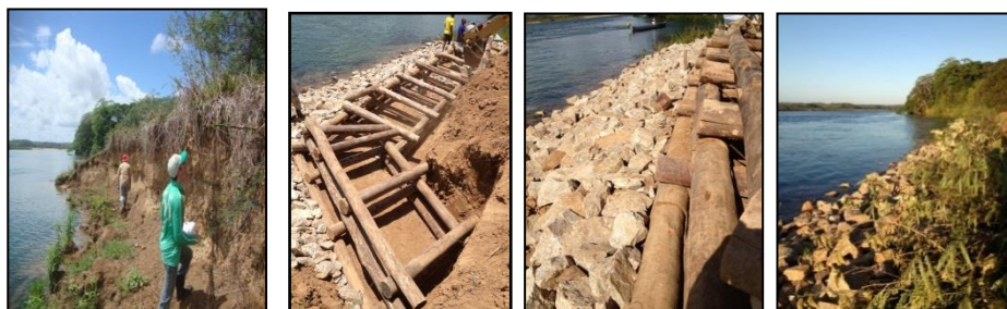
FIGURA 4 – Talude verticalizado em processo erosivo e etapas de implantação da técnica de Parede Krainer.
