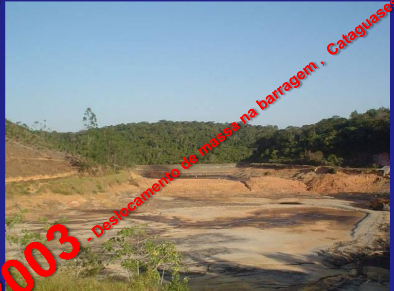
2015 - Deslocamento de massa na barragem, Mariana (MG).
