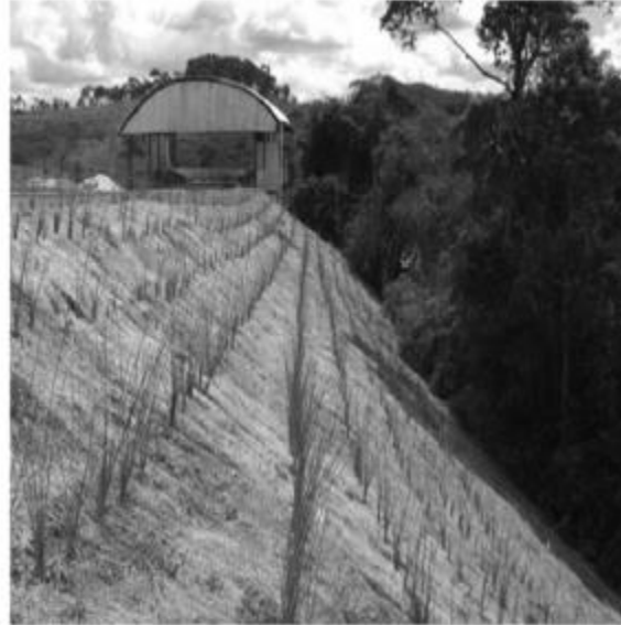
Foto 2 – Atiramento verde com biomanta antierosiva e vetiver de aterro sem compactação e em apenas 30 dias, protegem o talude, pois não houve trincas, carreamento de sedimentos e erosões.
